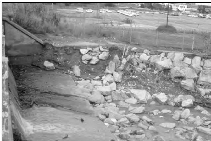
FIGURA 4. Escullera de protecció de la riera de Caldes, desmantellada per la crescuda del 10 d'octubre de 1994.
